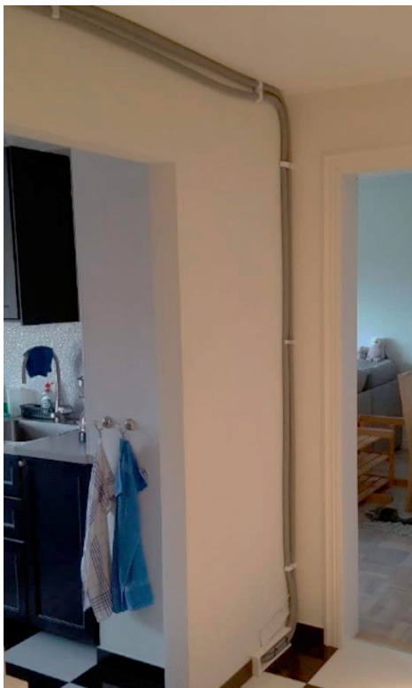
Tappvattenrör indragna från trapphus till hall i lägenhet. Rören är dragna i tak- och väggvinkel.
